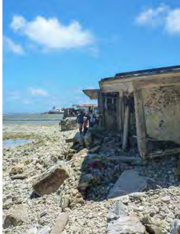
Dette huset på Majuro kollapset da bølgene vasket ut grunnfundamentet. Foto: Are Erik Brandvik, UiB
