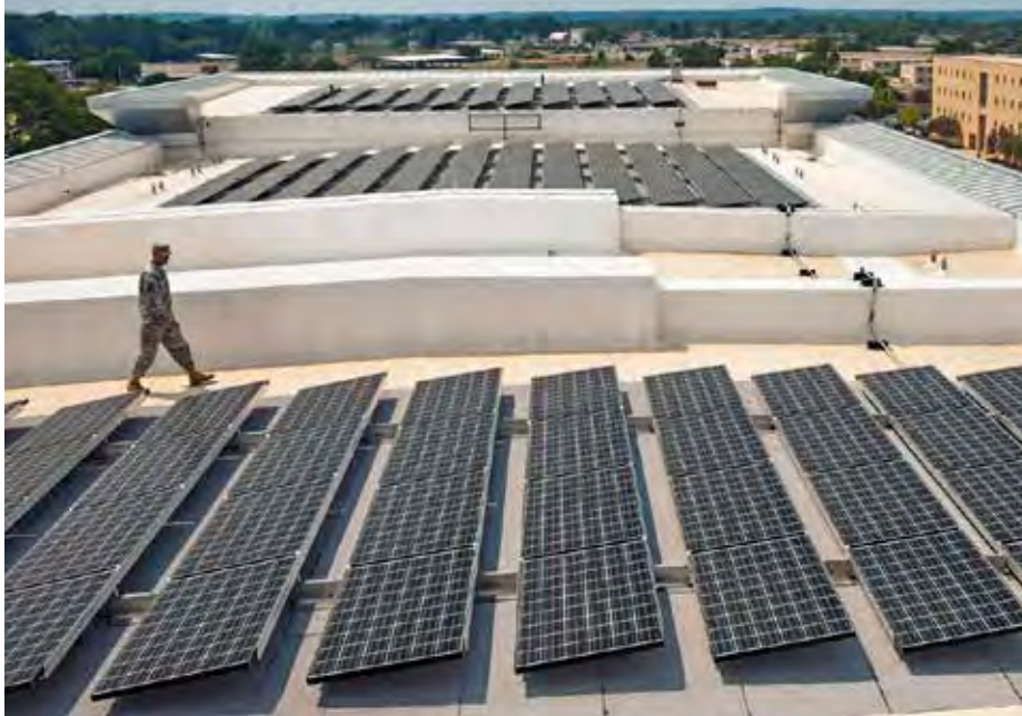
Solcellepaneler produserer strøm til militærbasen Fort Benning i Georgia, USA. Foto: US Army Corps of Engineers. Creative Commons
